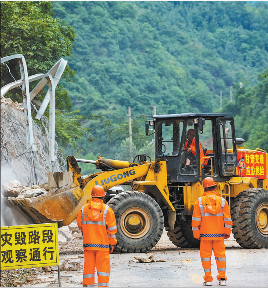
日前，甘肃陇南市启动防汛抗洪二级应急响应，各县区、各部门全面开展隐患排查、基础设施抢修等工作，守护群众生命财产安全。图为8月2日，陇南市武都区枫相乡草坪村，公路抢险人员正在清理S206线塌方落石。
